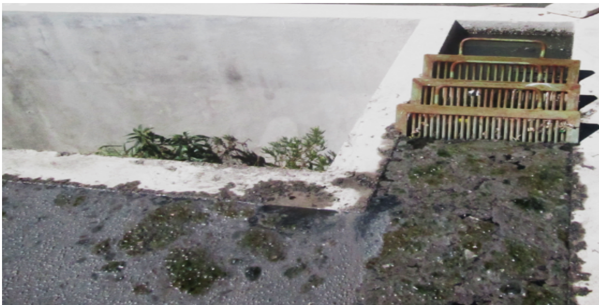
Figura 03: Trampa de grasa colmatada.
