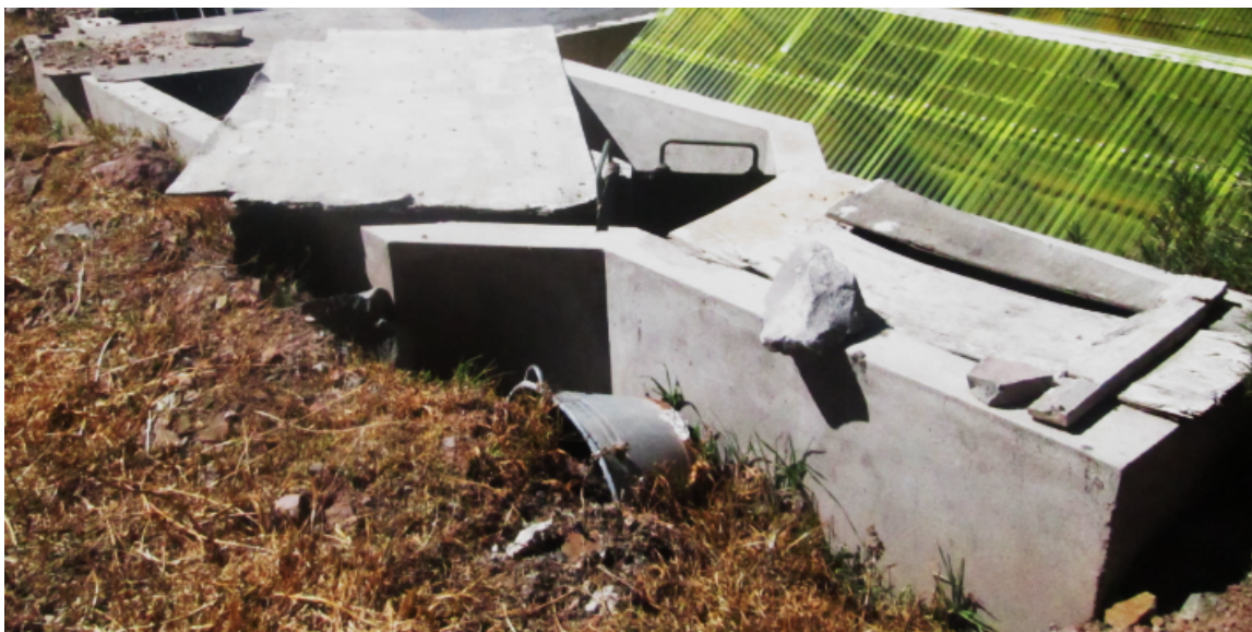
Figura 01: Desarenador de aguas residuales. La imagen muestra un desarenador completamente abandonado, sin ningún tipo de mantenimiento.
