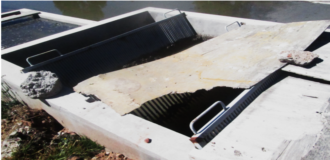
Figura 02: Cámara de rejas colmatada.
